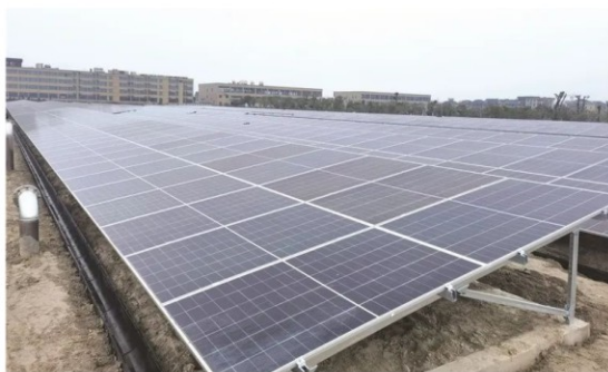
▲ 光伏新能源项目
